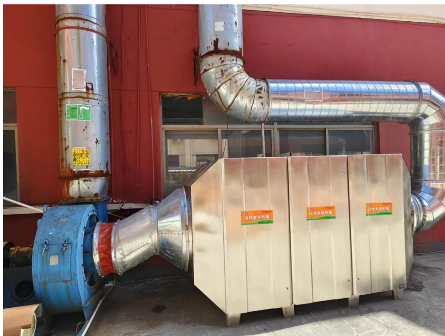
活性炭处理装置 1 及排气筒 (DA001) 标志
